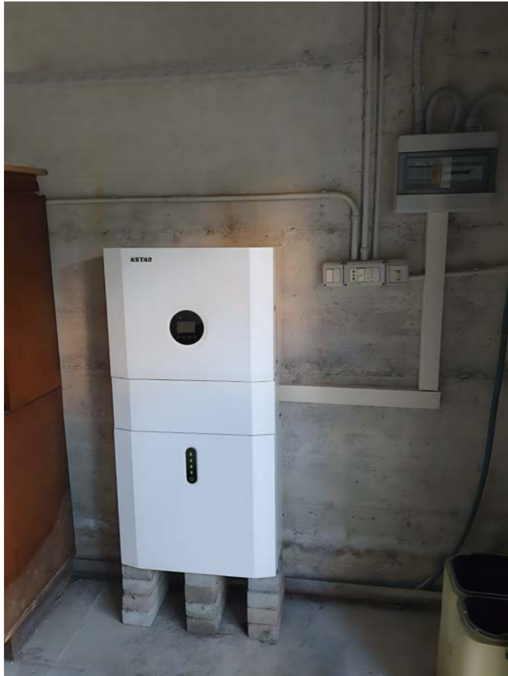
01 Proyecto ESS Residencial en Italia
