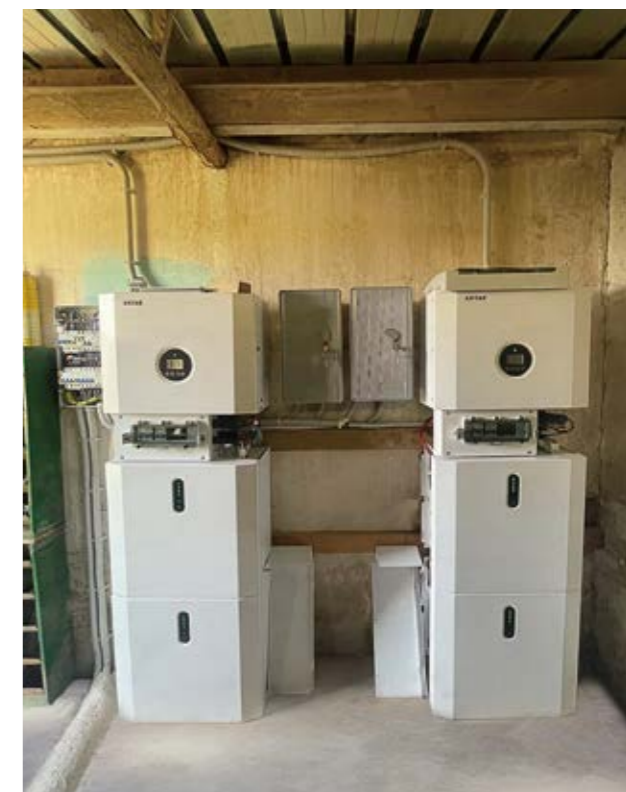
05 Proyecto ESS Residencial en Italia
