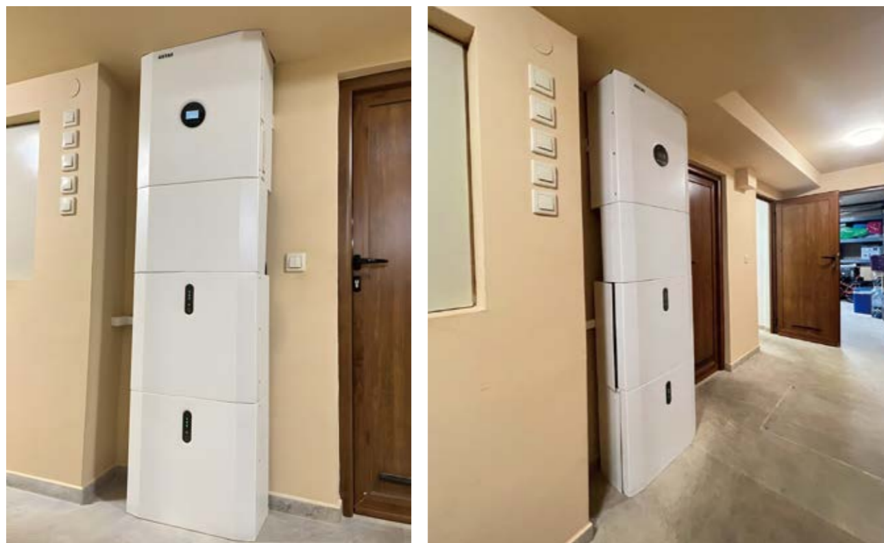
03 Proyecto ESS Residencial en Bulgaria
